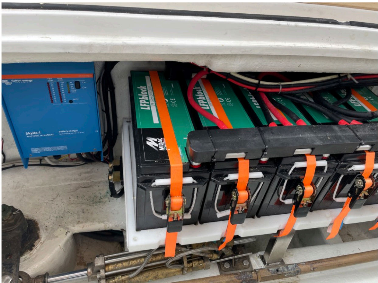
N. 2 banchi batterie litio 500 Ah cad.
